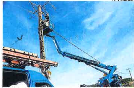
Quatre agents d'Enedis (le réseau d'électricité) se sont rendus sur place avec une grue.
